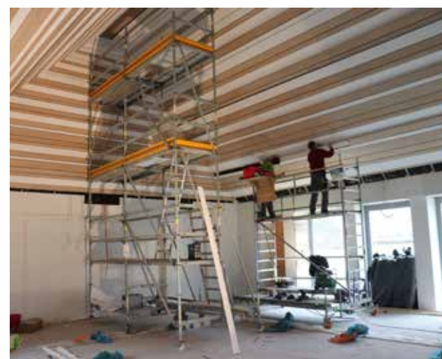
Blick in den neuen Sitzungssaal. Beim Tag der offenen Tür am 1. Juni kann dieser ebenfalls besichtigt werden.
